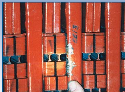
Отслаивание краски на лобовой части обмотки по причине вибрации и трения об листы сердечника.
